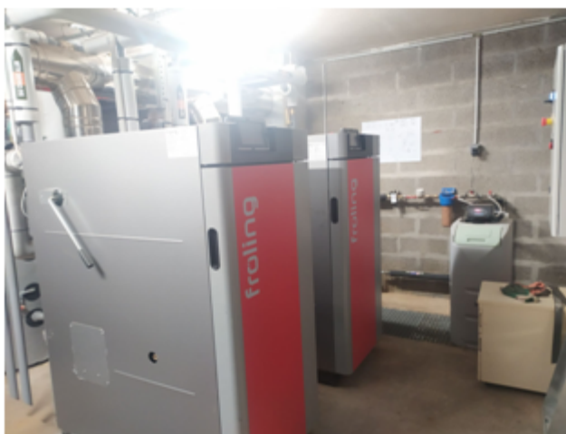
Chaudière Bois Bûche, mars 2022
